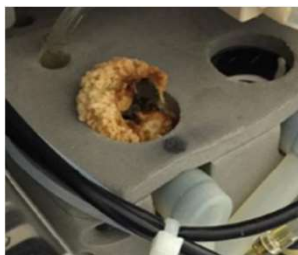
<汚れがある状態>
